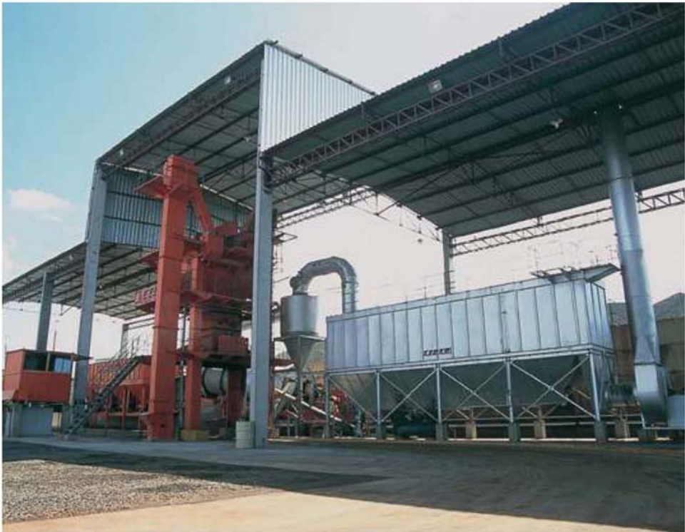
Vista geral da usina.
